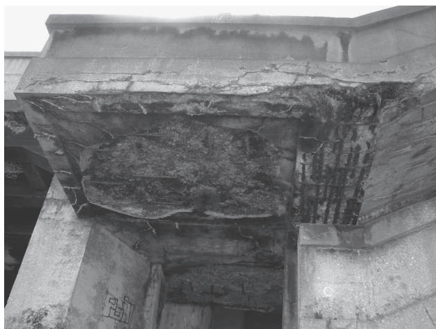
Schodiště; oslabení výztuže a hloubková degradace betonu – havarijní stav
