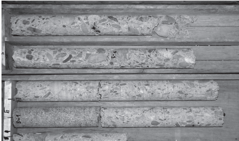
Typický hutný a homogenní beton těla pilířů a oblouků. Obsah velkých zrn kameniva. Průměrná pevnost v tlaku u pilířů cca 24–25 MPa u oblouků 31 MPa tj. cca 2× větší než požadovaná pevnost v době návrhu ve dvacátých letech 20. století. Pilíř 3 při číslování z holešovické strany.
