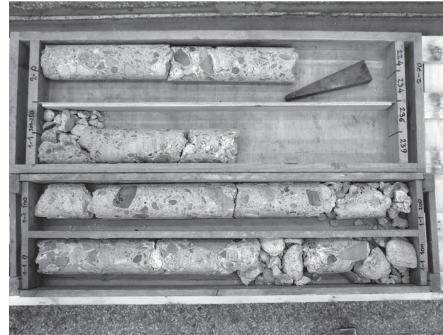
Typický mezerovitý beton základů s velkým kamenivem a relativně nízkou pevností do 10 MPa. Pevnost v tlaku je cca 2× vyšší než byl požadavek v době návrhu ve dvacátých letech 20. století. Pilíř 3 při číslování z holešovické strany.
