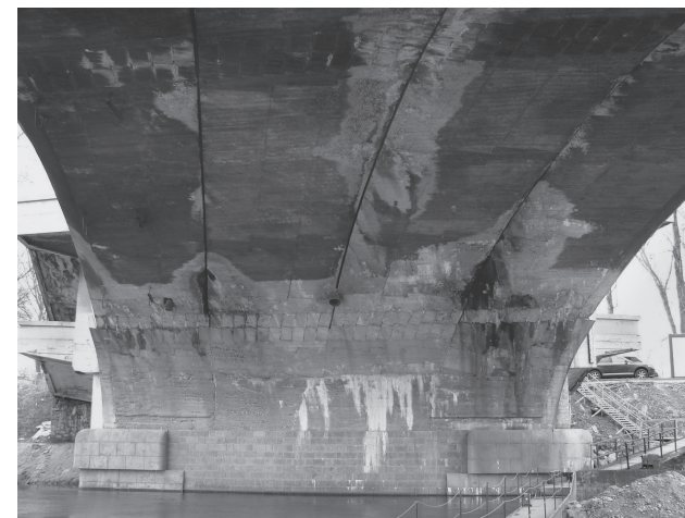
Degradace betonu oblouku a opěry v důsledku průsaků a zatěžování v kombinaci s účinky mrazu
