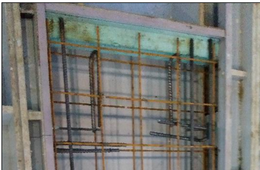
obr.47. Pohled do formy – výztuž obou povrchů dovedena až do ozubů drážky styku
