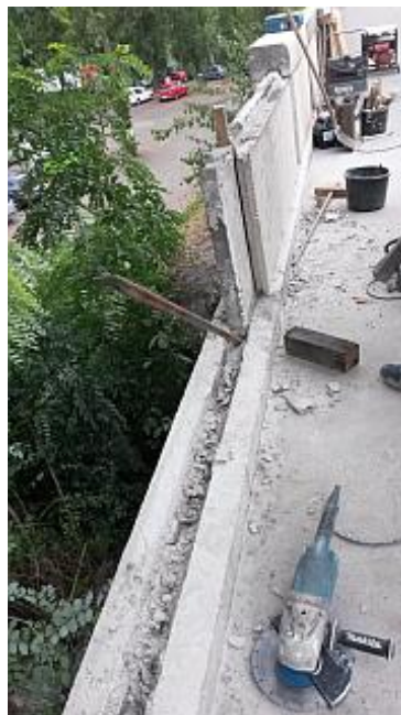
obr.24. Uvolňování sloupku, spodní líc sloupku a detail kotevního prvku sloupku
