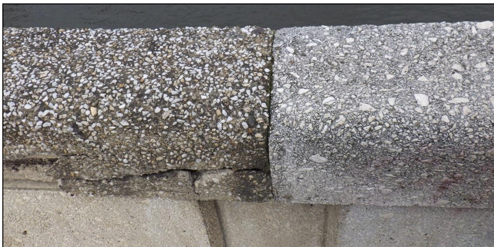
obr.11. Příklad sousedství evidentně rozdílných madel – vlevo patrně vyměněno, viditelná porucha podobného madla v jiném úseku mostu
