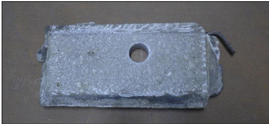
obr.31. Pohled na prefabrikovaný sloupek po jádrovém provrtání, vystupující zahnutá ocelová výztuž, zbytky cementové zálivky na okrajích jeho per
