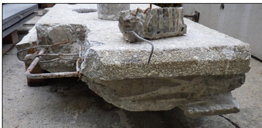
obr.46. Prakticky nevyztužené ozuby drážky styku originálních prefabrikátů
