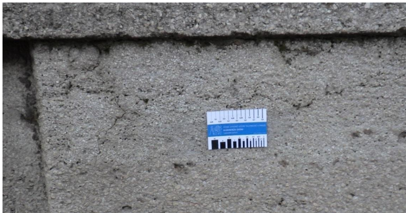
obr.10. Příklad panelu s jemnější drtí a velmi nekvalitním povrchem s řadou trhlin
