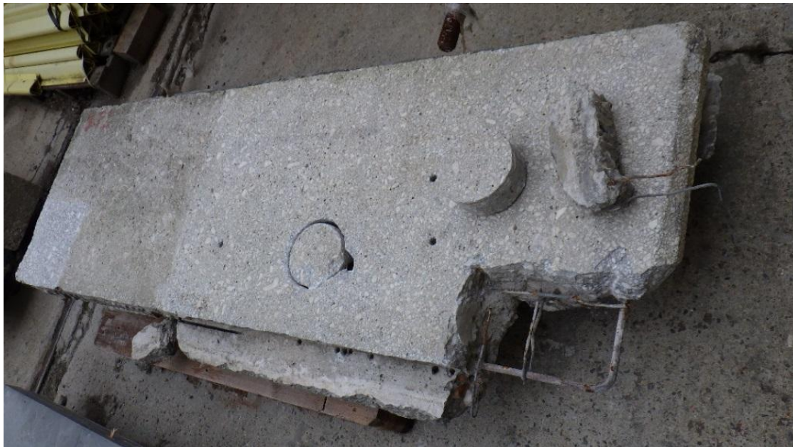
obr.26. Demontovaný zábradelní panel ve fázi destruktivního sondování na dvoře KÚ ČVUT v Praze
