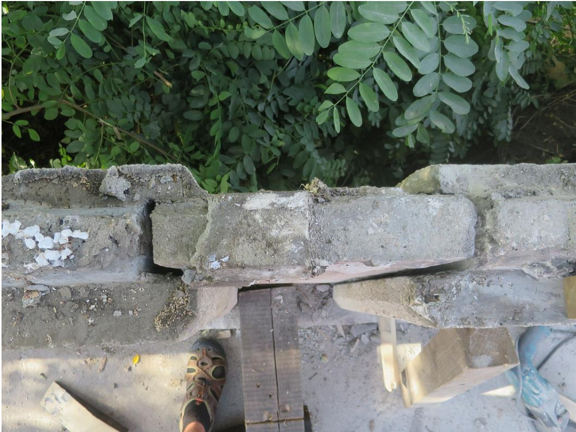
obr.23. Částečně uvolněné spáry mezi sloupkem a výplní
